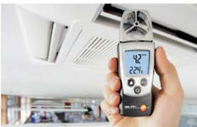
testo 410迷你型叶轮风速仪 出风口现场检测
